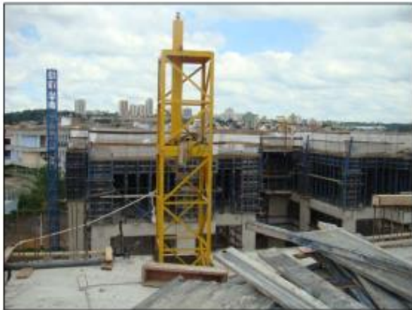
Ausência de guarda-corpo
