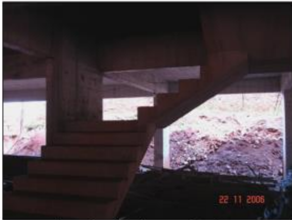
Ausência de corrimão
