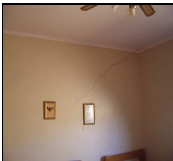
Figura 12 – Fissura típica de recalque diferencial
