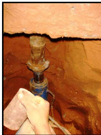
Figura 4 – Macaco hidráulico instalado
